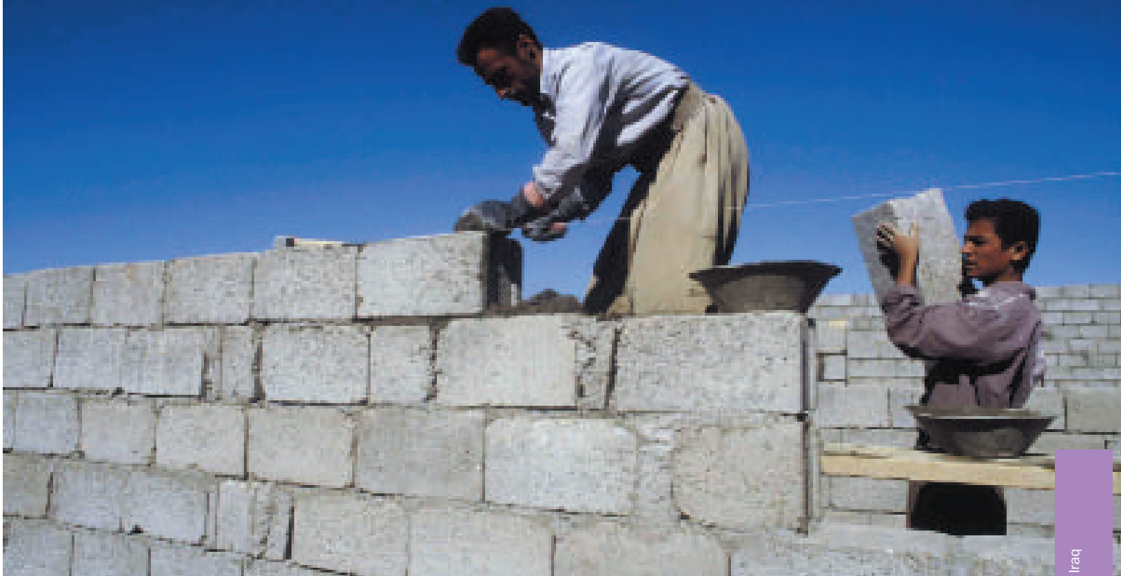
Avec l'aide d'une ONG locale, des réfugiés kurdes iraniens construisent des maisons dans le secteur de Barika, à Souleymaniyah, en Iraq du Nord . UNHCR / A. Eriksson
