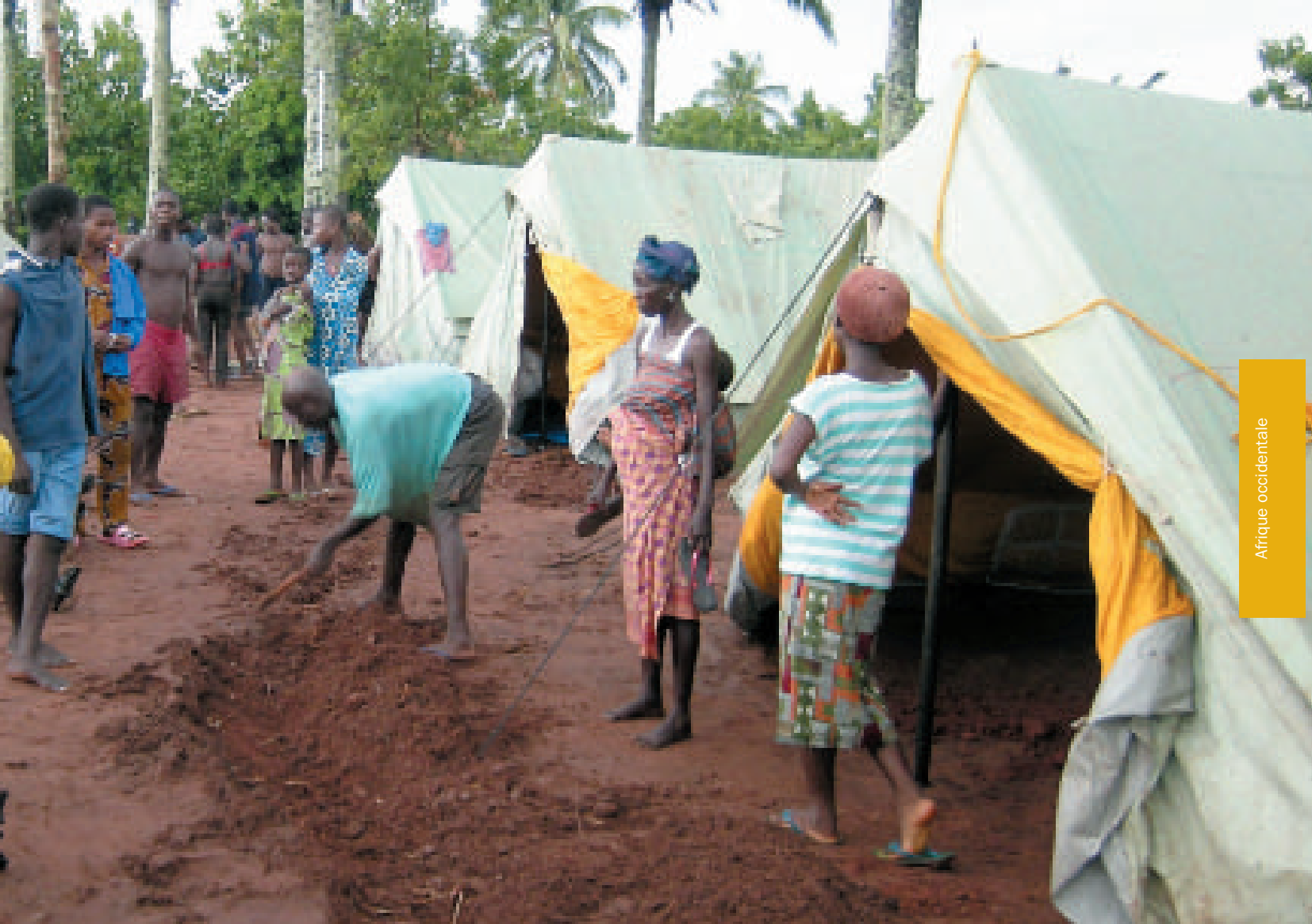
Bénin : un réfugié togolais récemment arrivé à Agoué creuse des tranchées autour des tentes pour prévenir les inondations pendant les pluies. UNHCR / J. Björgvinsson
