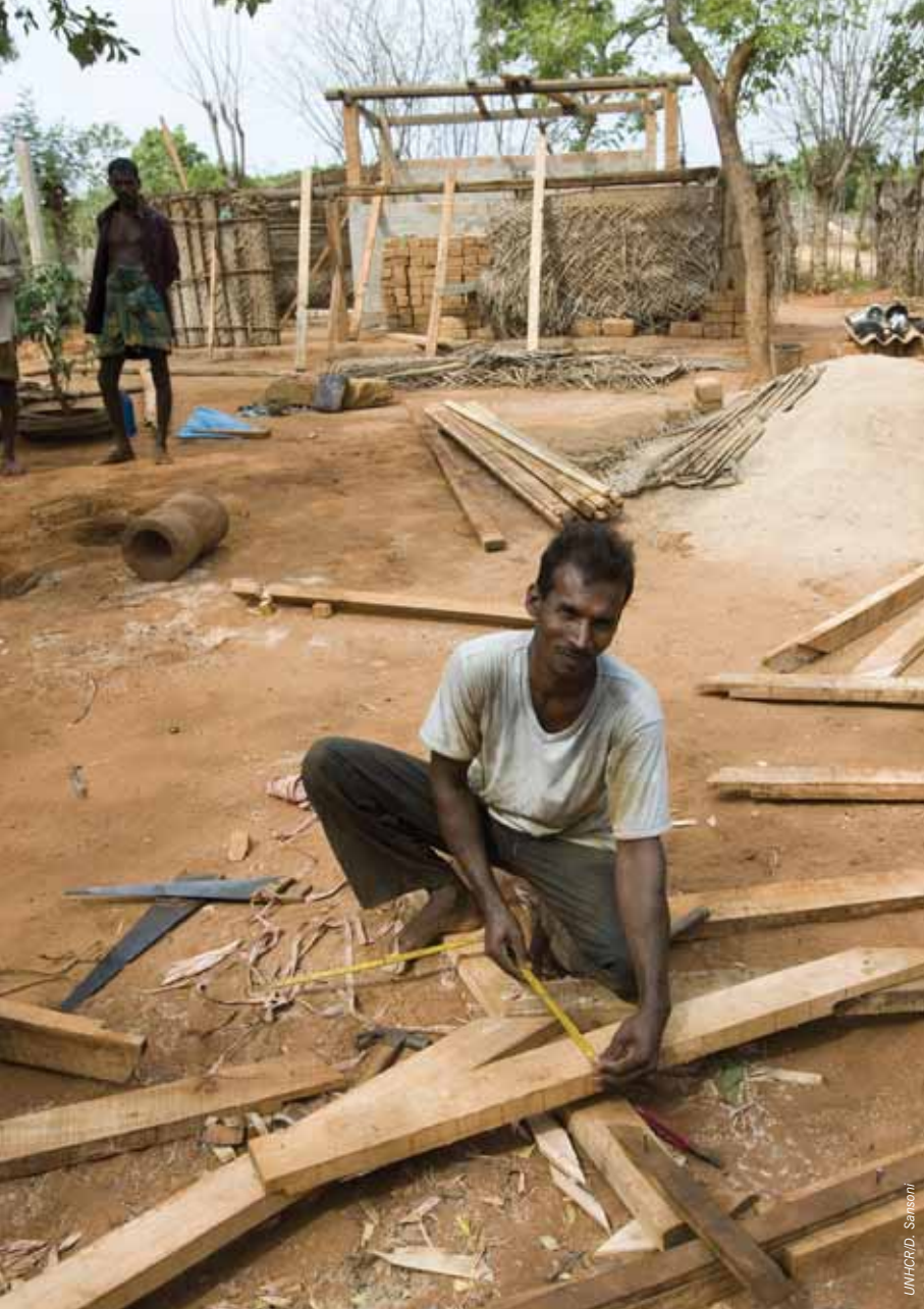
Construction d'abris pour des personnes récemment déplacées à Jaffna, au Sri Lanka.
