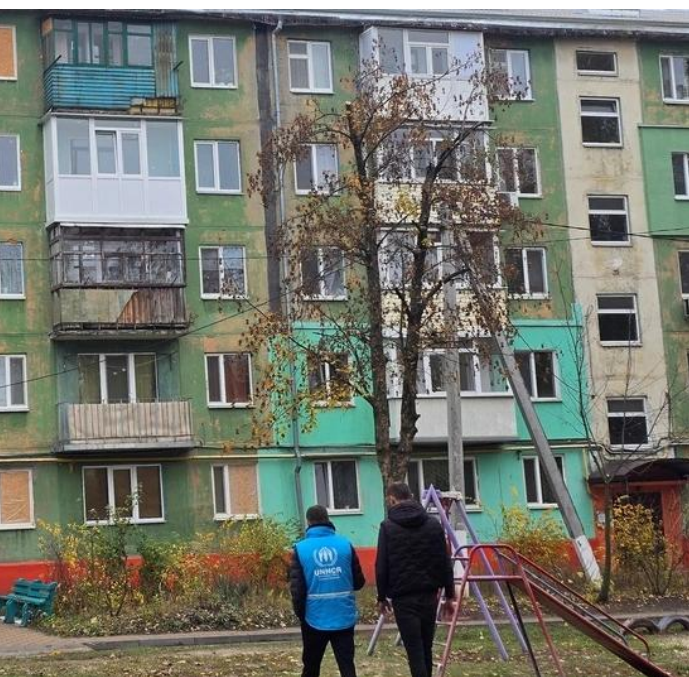
Багатоквартирний будинок у м. Павлоград Дніпропетровської області, в якому УВКБ ООН здійснювало відновлювальні роботи в місцях загального користування. © УВКБ ООН / Вікторія Тютюнник
